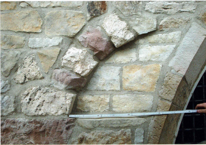
Michaeliskirche in Hildesheim: Freilgelegter Ottonischer Bogen der polychromen Südfassade
