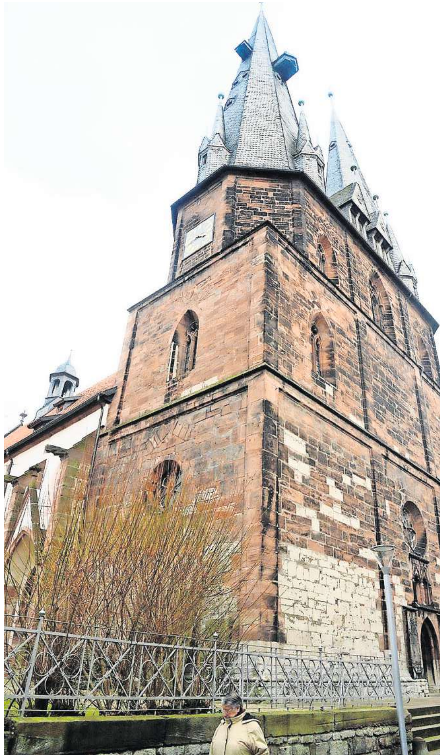
Die Sanierung der St.-Nicolai-Kirche in Alfeld ist das umfangreichste Projekt des Programmes.
