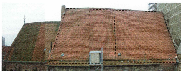
Bild 5 Versackung des Dachfirses durch die zerstörten Sparrenfüße und Bundbalkenköpfe
