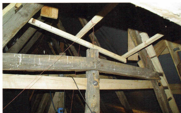
Bild 9 Hängesäule mit historischem oberstem Kehrlriegel und neu eingezogenem. Der alte Kehrlriegel wurde aus denkmalrechtlichen Gründen belassen. Das Bild zeigt die Ebene 5.
